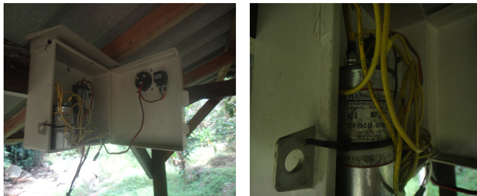
ภาพที่ 4.3 ชุดควบคุมระบบและชุดควบคุมไหล (ที่มา : อีลิหัยะ สนิโซ, 2554)
