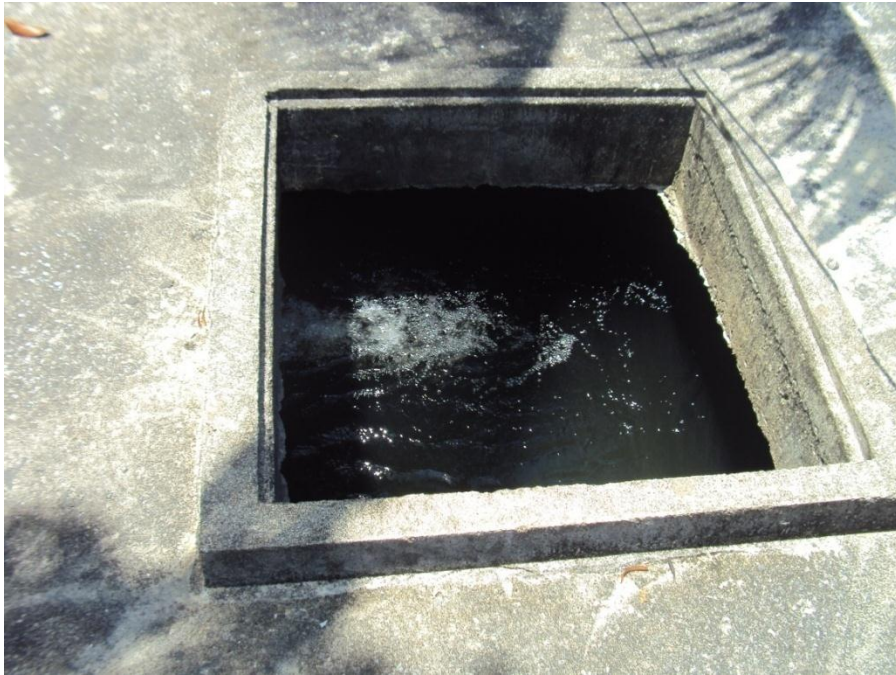
ภาพที่ 25 แสดงภาพปากบ่อพักน้ำ มีขนาดประมาณ 1 ตารางเมตร สภาพไม่มีฝาปิด
