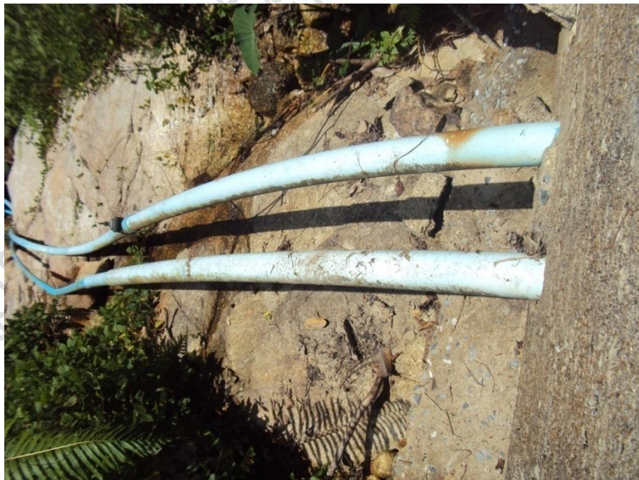
ภาพที่ 22 แสดงภาพท่อส่งน้ำใต้ฝายทดน้ำ เป็นท่อพี.วี.ซี. จำนวน 2 ท่อ ขนาด 3 นิ้ว ยาวจนถึงบ่อพักน้ำประมาณ 1,300 เมตร
