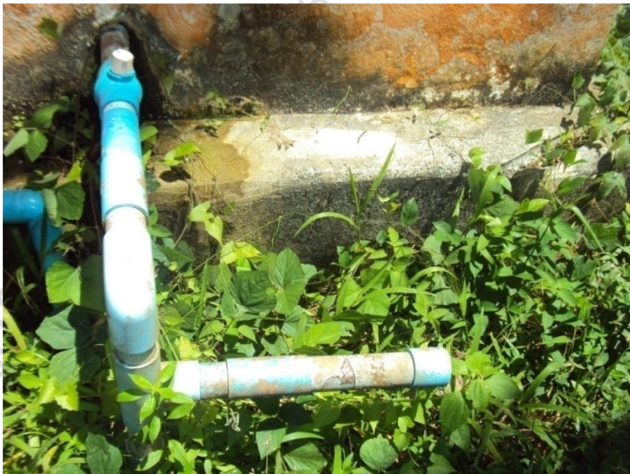
ภาพที่ 26 แสดงภาพจุดจ่ายน้ำ เป็นท่อพี.วี.ซี. ขนาด 2 นิ้ว แยกออกมาจากท่อส่งน้ำ ซึ่งออกมาจากบ่อพักน้ำ
